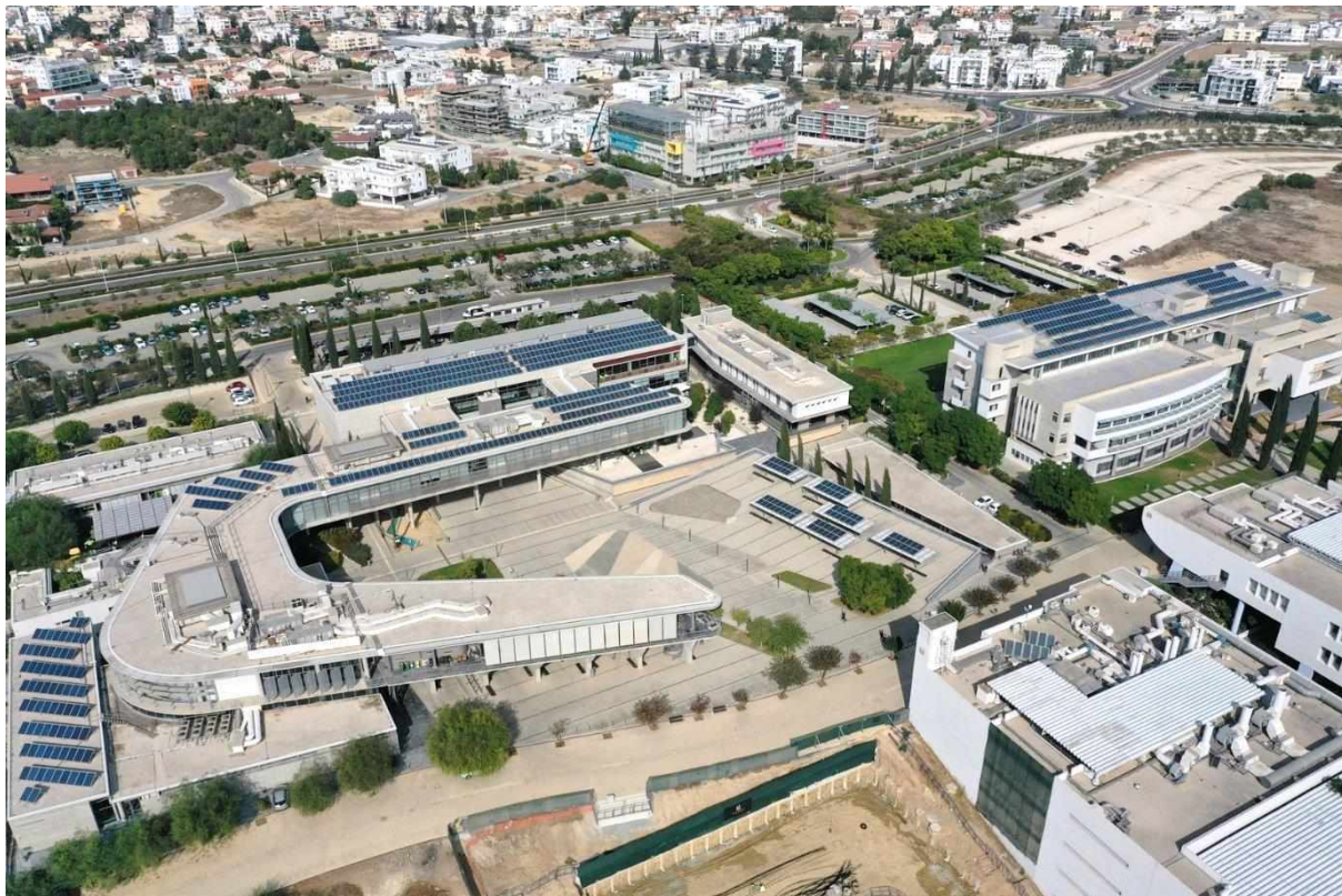
Φωτογραφία 6.7: Εγκαταστάσεις φωτοβολταϊκών συστημάτων στις οροφές κτηρίων.
